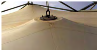
altos quedan colgando en lugar de estar apoyados Pabellón Ambiente, EXPO 92 , Sevilla
